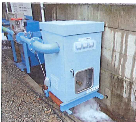
三峰川第一発電所内試験中
