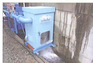
実証実験中のピコ水車発電機 (3kWエコ・ハイドロ発電装置)
