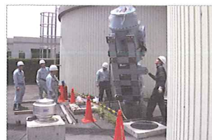
狭い搬入口から設置場所への吊り降ろし作業 (東京発電・山宮発電所)
