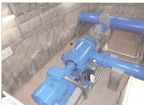
インライン式リンクレス・フランシス水車 (神奈川県葛原配水池)
